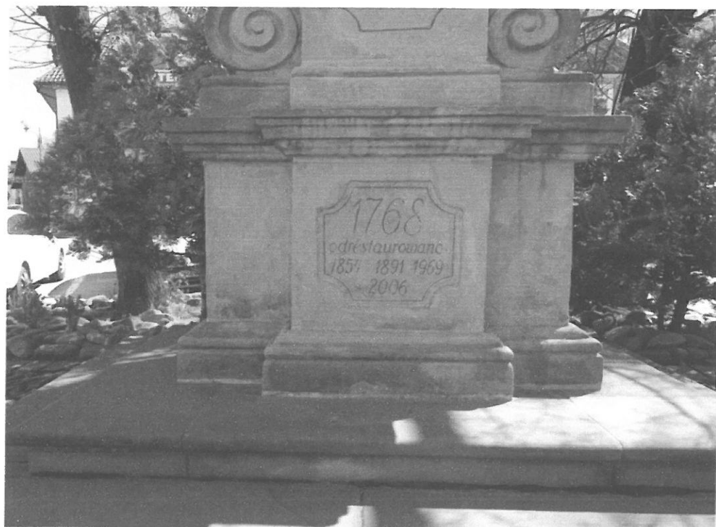
Fot. 3. Kapliczka Św. Floriana w Dobczycach, widok na postument od frontu, widoczne również ciemne zacieki z brudu oraz naloty organiczne. Fot. M. Książek 2019r.
