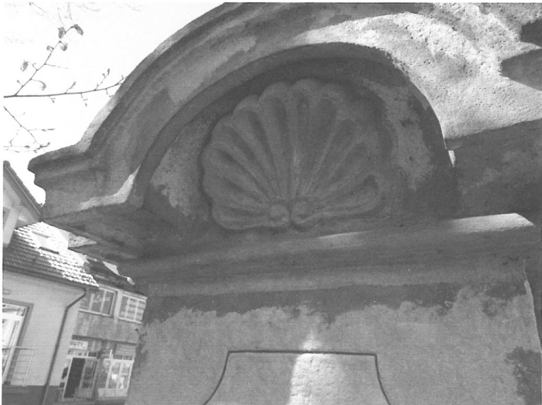
Fot. 7. Kapliczka Św. Floriana w Dobczycach, widok na postument od tyłu, widoczne pociemniałe i zmienione kolorystycznie kity. Fot. M. Książek 2019r.
