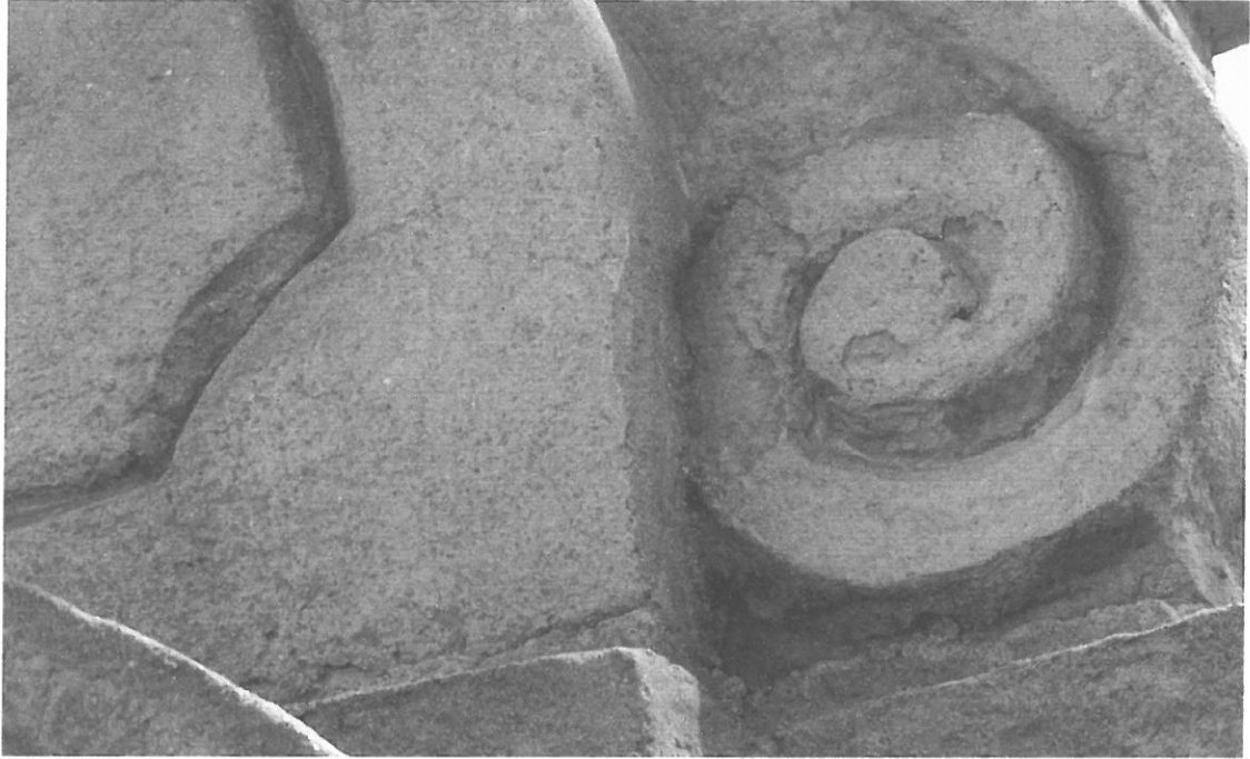
Fot. 6. Kapliczka Św. Floriana w Dobczycach, widok od frontu, widoczne ubytki kamienia. Fot. M. Książek 2019r.
